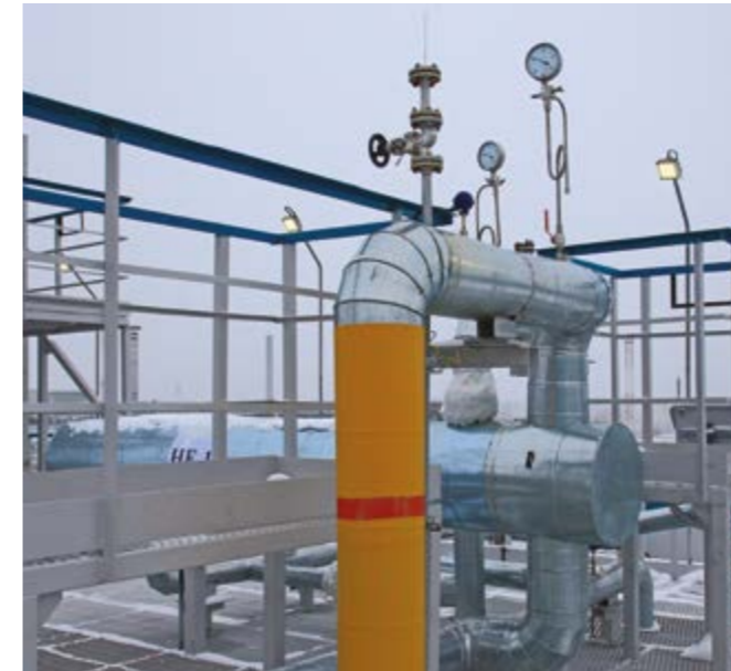
ПАО Сибурхолдинг (Южно-Балыкский ГПЗ)
