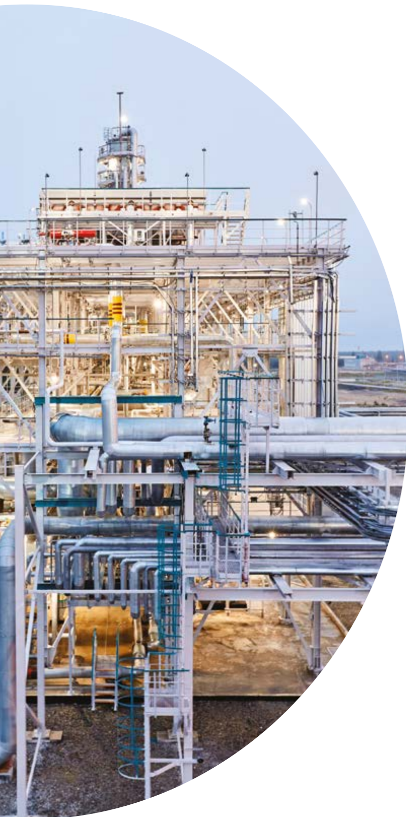
ПАО Сибурхолдинг (СибурТюменьГаз. Вынгапуровский ГПЗ)
