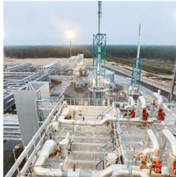
ПАО Сибурхолдинг (СибурТюменьГаз. Вынгапуровский ГПЗ)
