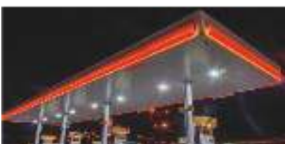
Освещение автозаправочных станций ООО ТД «Нефтьмагистраль», г. Москва, 2020 г.
