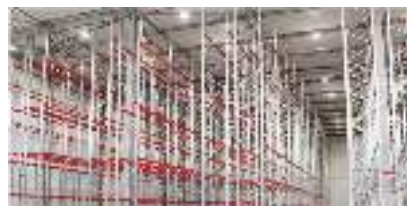
Освещение промышленных складов категории «А» ООО «СТ-Сторум», г. Волгоград, 2013 г.
